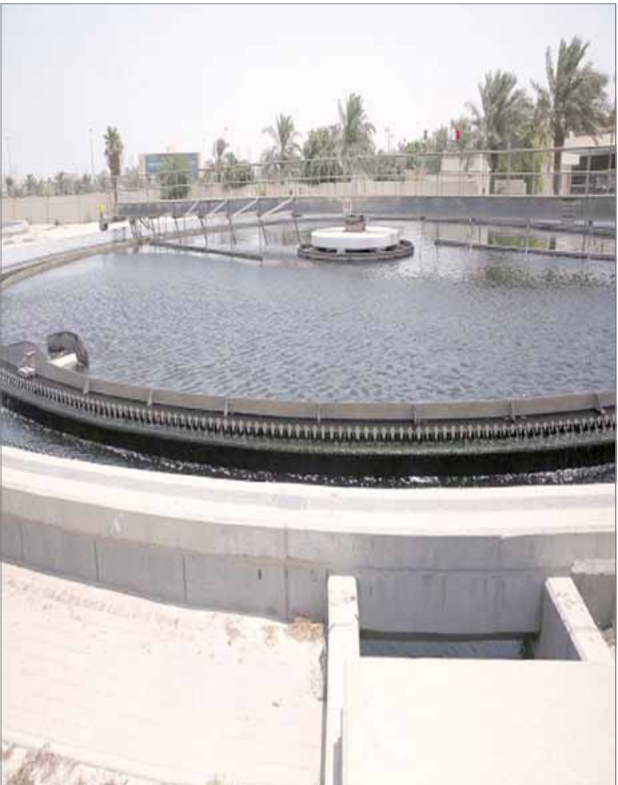
● محطة توبلي للصرف الصحي
