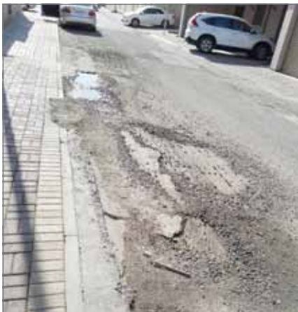
• جانب من تلفيات الشوارع بفعل المياه المهدورة
