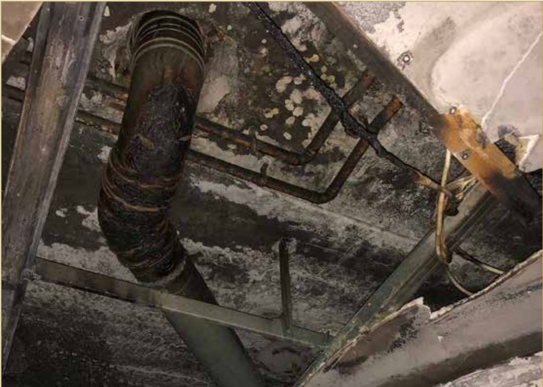
آثار الحريق في سقف المنزل
