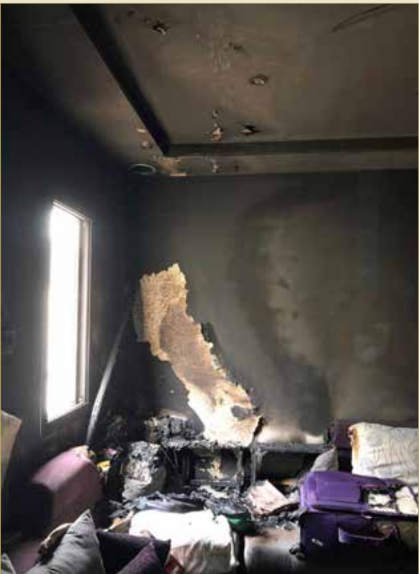
الحريق النهم كل غرف المنزل
