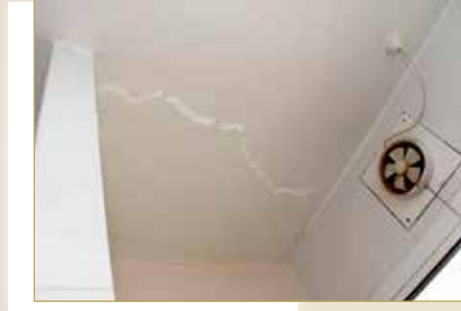
شقوق سقف دورة المياه
