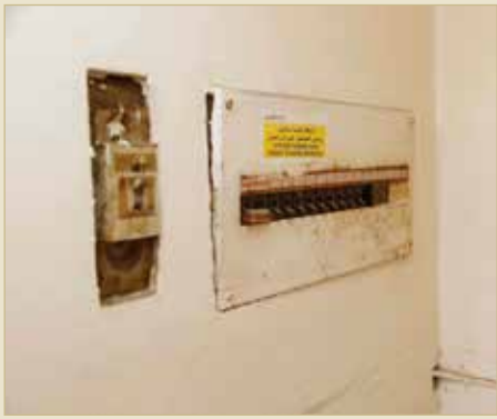
عداد كهرباء المبنى
