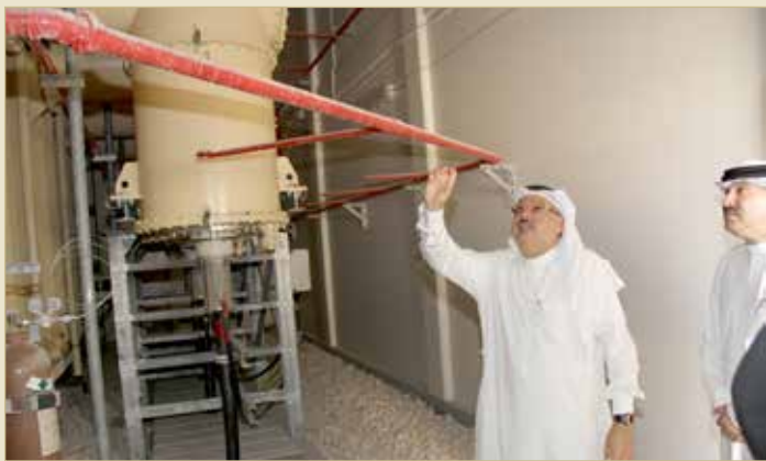
الرئيس التنفيذي لهيئة الكهرباء والماء أثناء تدشين خط الكهرباء الحيوي
