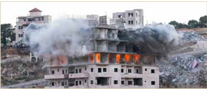
هدم مبنى فلسطيني قيد الإنشاء في قرية صور باهر في القدس الشرقية (أ ف ب)
