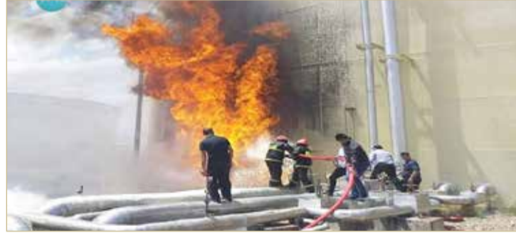
حريق هائل في محطة للكهرباء في سمنان في شمال إيران
