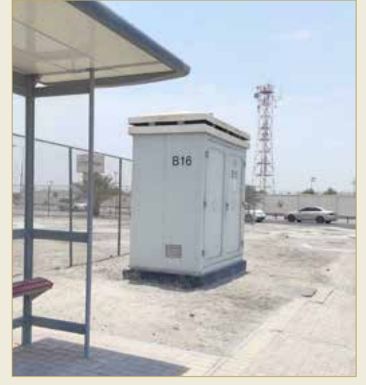
محطة مجاري (B16)
