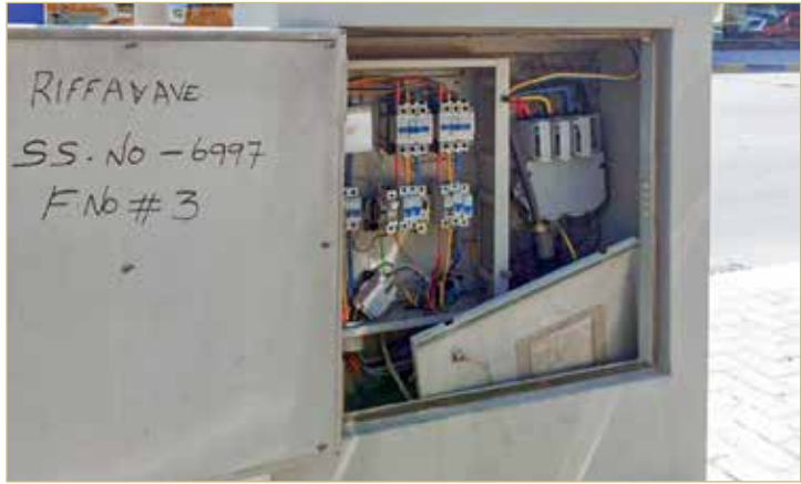
محول كهرباء مفتوح
