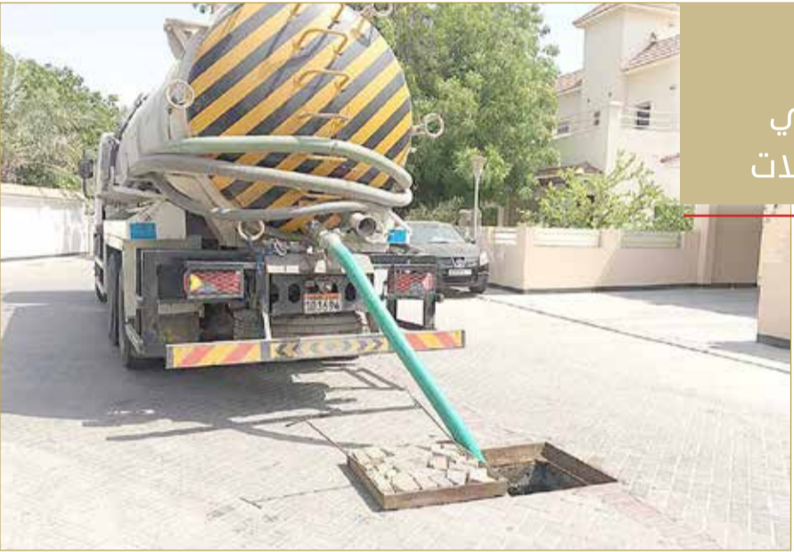
صهريج شفط مجاري
