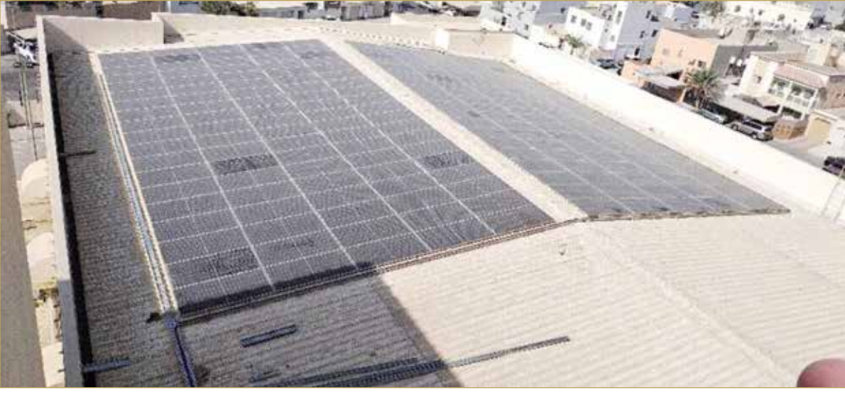
نظام الطاقة الشمسية على مباني مدرسة غازي القصبي الثانوية للبنات
