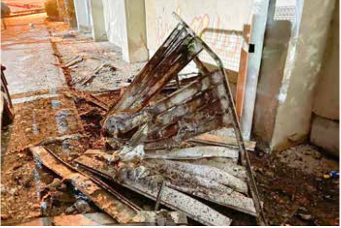
من أضرار الحريق داخل السجن
