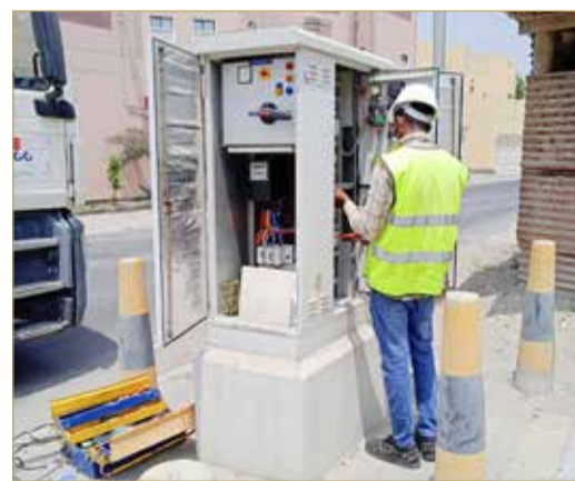
صيانة وقائية للوحة التحكم الخاصة بمحطة ضخ مياه الصرف الصحي
