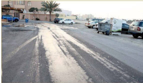
امتلاء الشوارع بمياه الصرف الصحي
