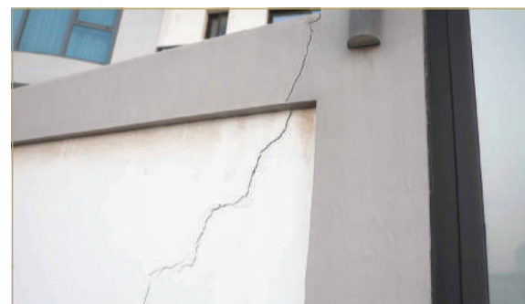
تشقق جدران المنازل بسبب فيضانات مياه الصرف الصحي
