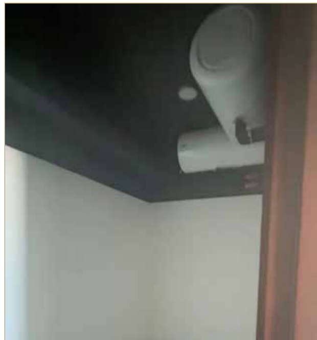
سكانات المياه مكشوفة في الشقة المستلمة بينما كانت غير مكشوفة في الشقة النموذجية (مصدر الصورة: المواطنة صاحبة الرسالة)
